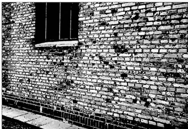
Ryc. 149. Ślady kul niemieckich na ścianie nawy północnej – pierwsze okno od wieży
